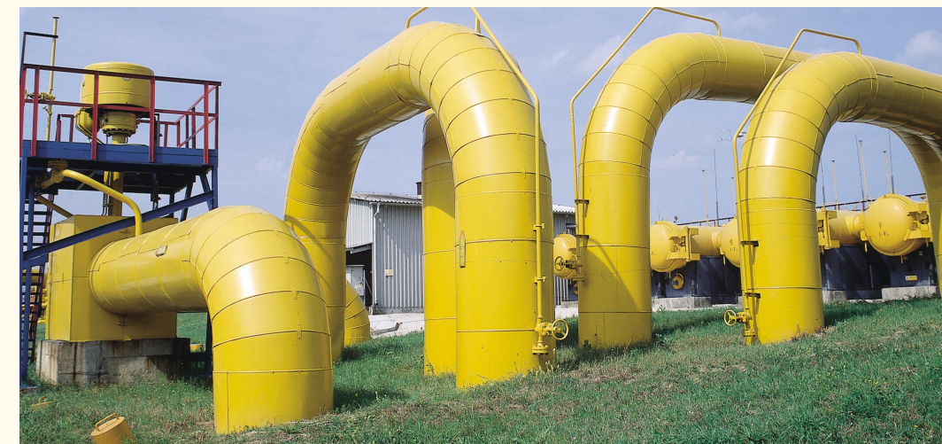
Potrubný dvor na kompresorovej stanici
